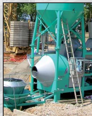
> Cuve de malaxage
